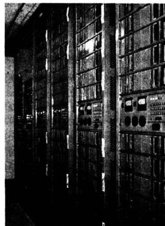
6 現示機器集中方式の軌道回路送受信機
